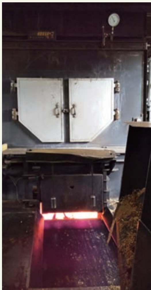
▼写真3 木屑(バイオマス)焚きボイラー
